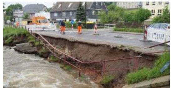
An der Hartmannsdorfer Hauptstraße rissen die Wassermassen Teile der Uferbefestigung und des Fußweges weg.
